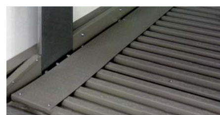
Laufsteg auf Trapezblech für bessere Begehbarkeit
