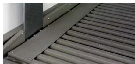
Laufsteg auf Trapezblech für bessere Begehbarkeit
